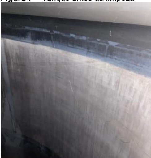
Figura 7 – Tanque antes da limpeza
