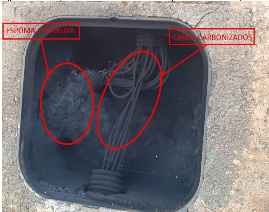
Figura 3 – Caixa de passagem subterrânea c/ evidência de queima de cabos e fumaça residual
