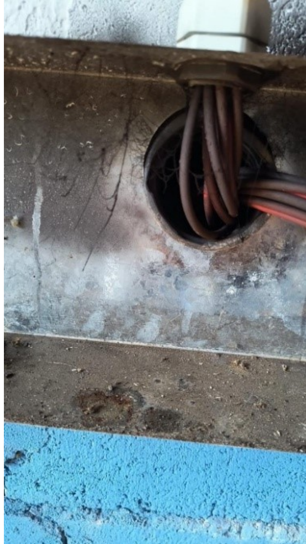
Figura 6 - Fuligem em eletroduto com indícios de curto-circuito
