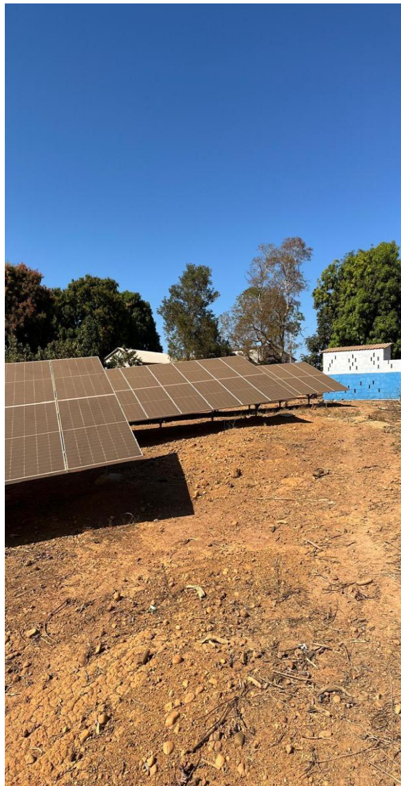
Figura 4 – Módulos fotovoltaicos instalados em solo na zona rural de Paracatu/MG
