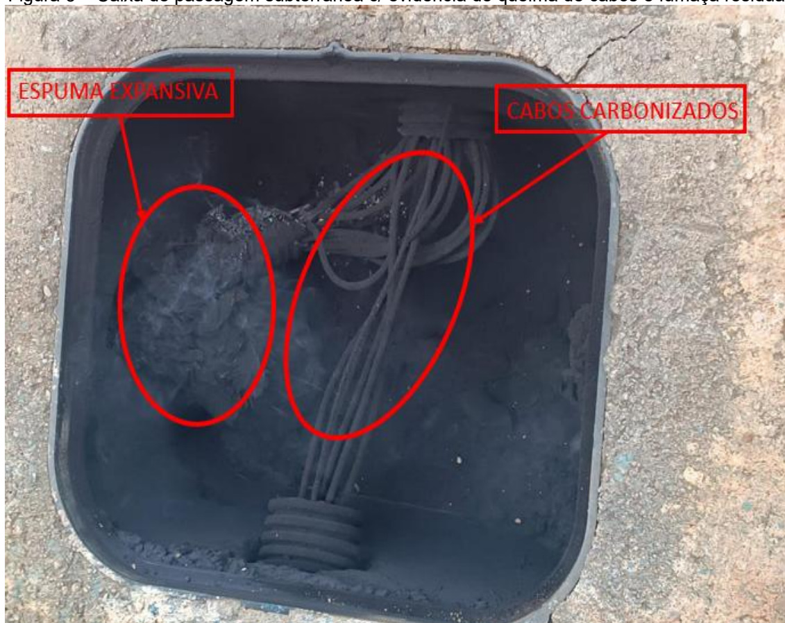
Figura 3 – Caixa de passagem subterrânea c/ evidência de queima de cabos e fumaça residual
