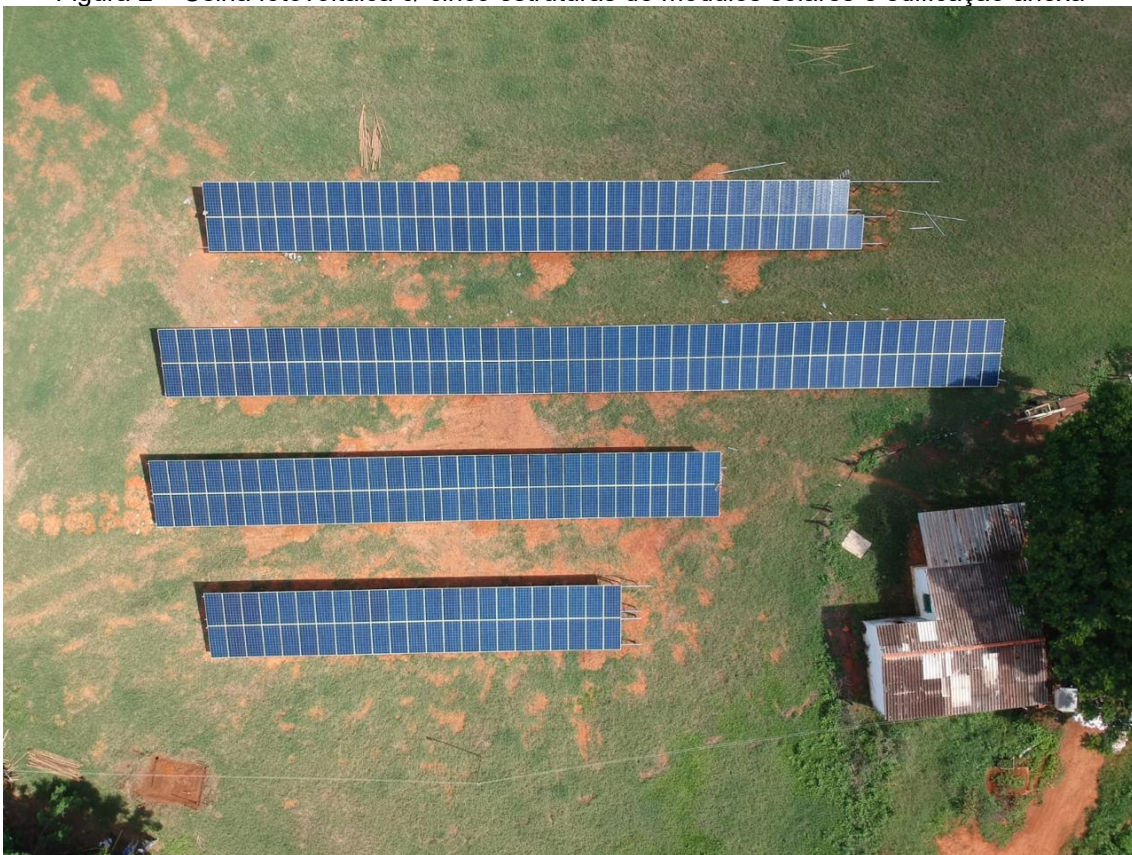
Figura 2 – Usina fotovoltaica c/ cinco estruturas de módulos solares e edificação anexa
