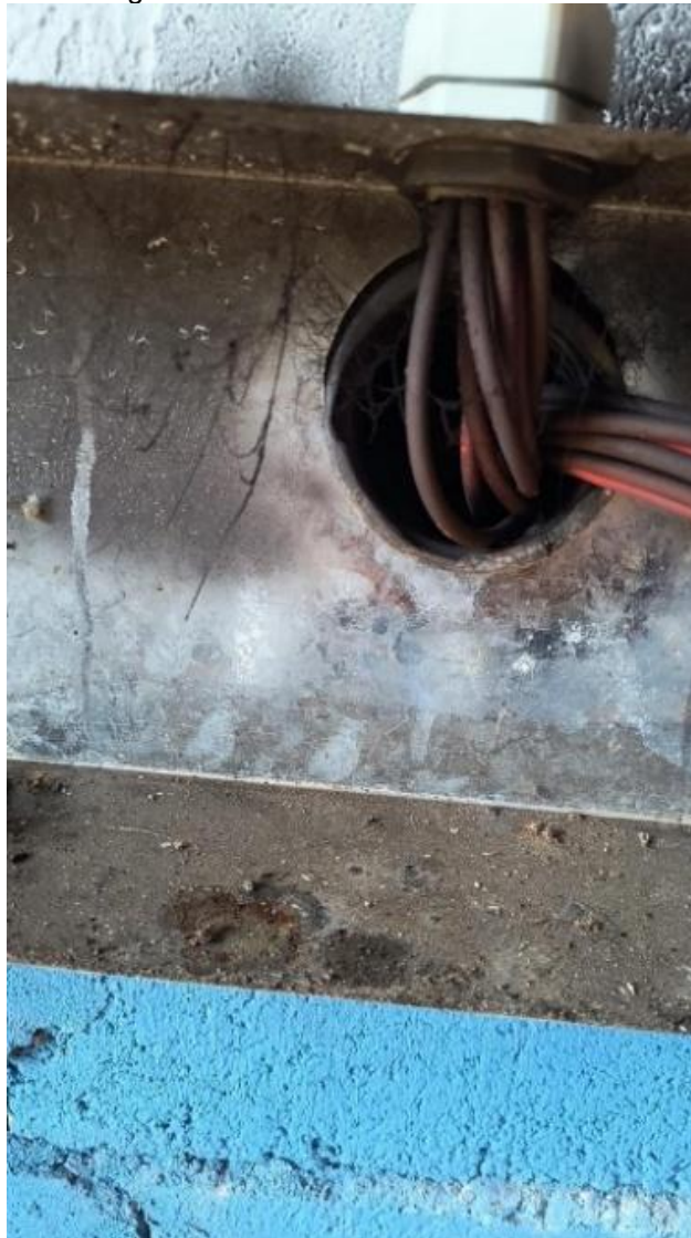
Figura 6 - Fuligem em eletroduto com indícios de curto-circuito
