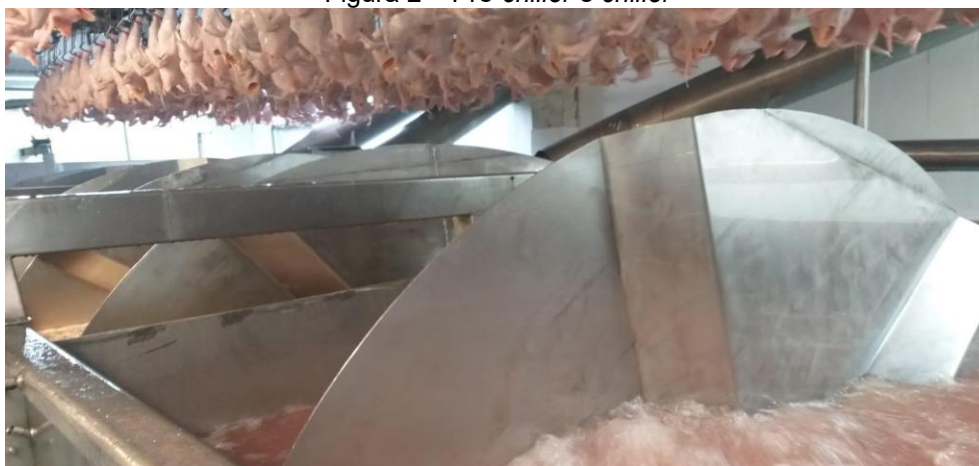
Figura 2 – Pré-chiller e chiller
